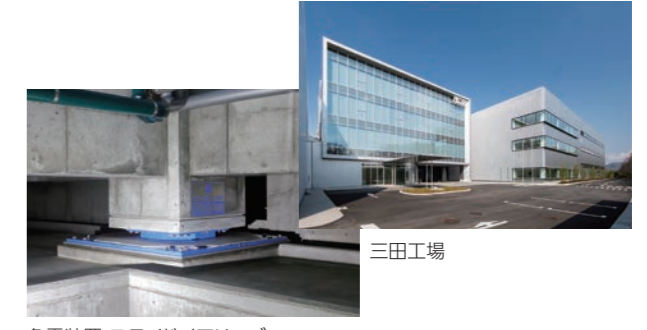
免震装置・スライドベアリング
