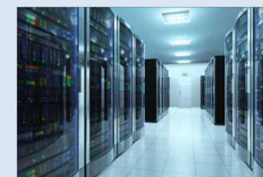
データセンター
