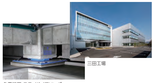
免震装置・スライドベアリング
