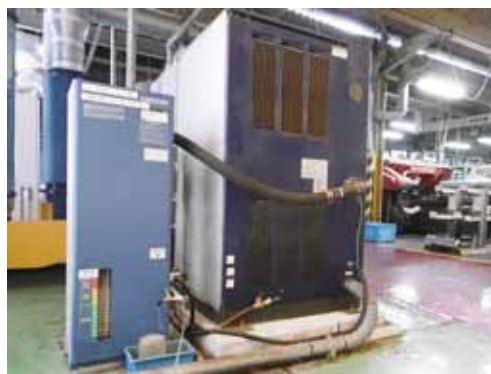
油フィルターの設備更新を実施
